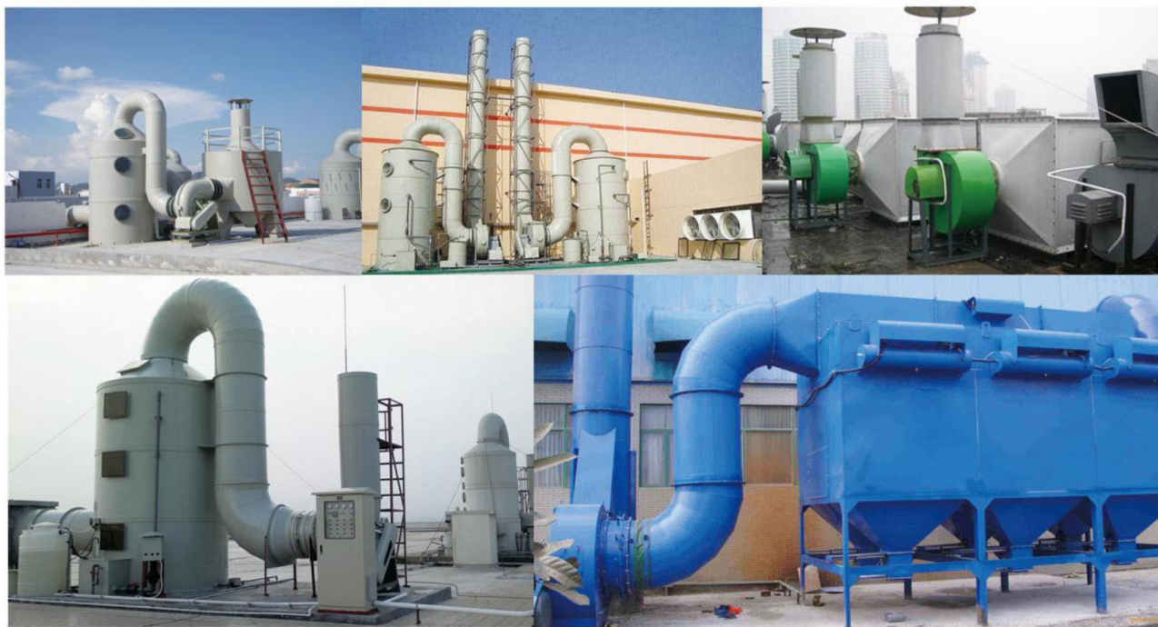
废气处理系统
